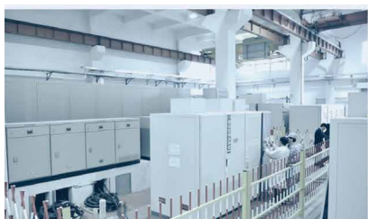
高压负载测试站
